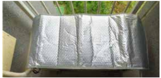
실외기 커버 설치
